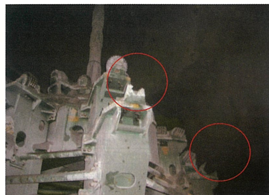
図 19 カッターローラー脱落
