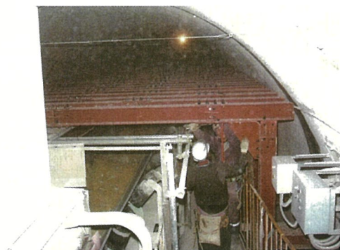
図 6 既設 BC 防護工
