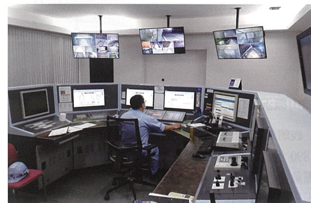
写真6 中央制御室の様子
